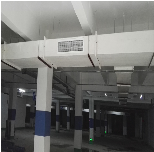
地下车库通风系统
