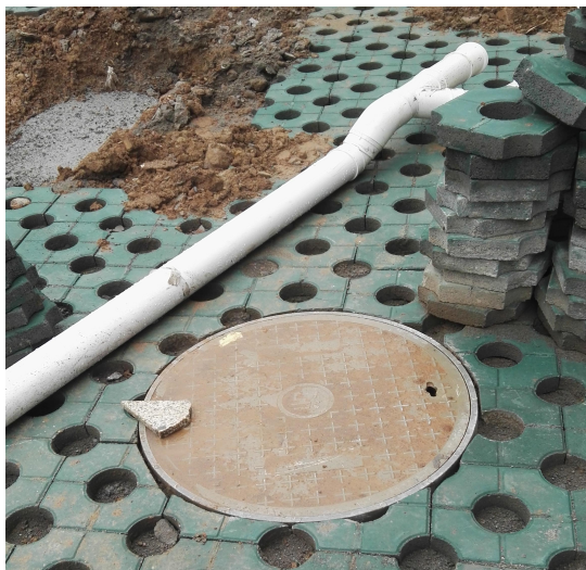
小区污水排放口
