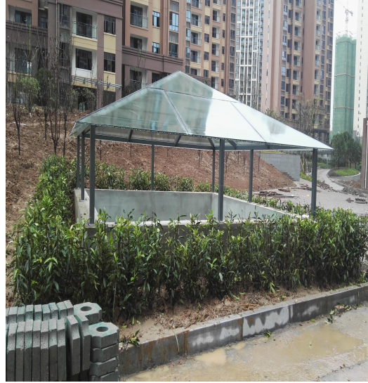
车库地面排风口
