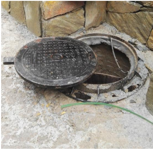
小区污水排放口
