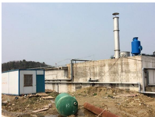
已建成的污水处理设施
