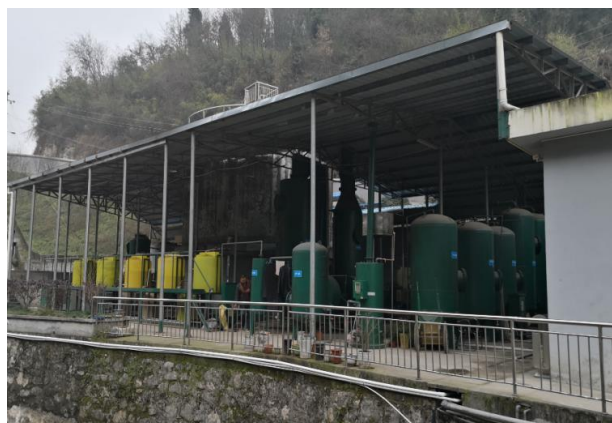
渗滤液处理站
