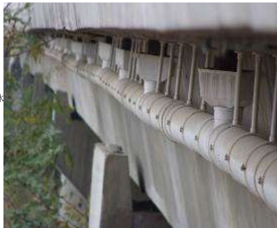
桥面径流收集系统
