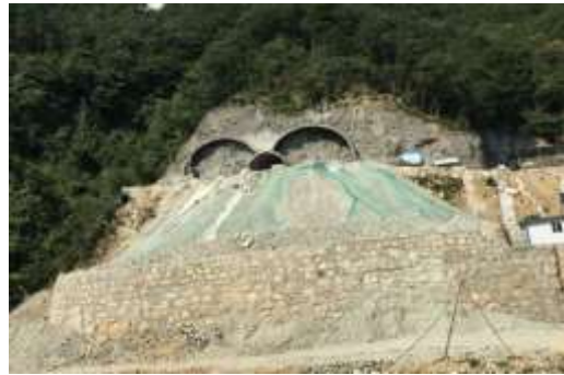
唐家坝隧道入口现状（K18+185）
