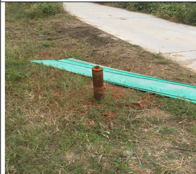
2#地下水监测井
