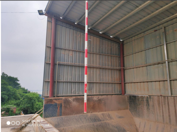
图 3.8-3 半封闭进料口及喷淋设施
