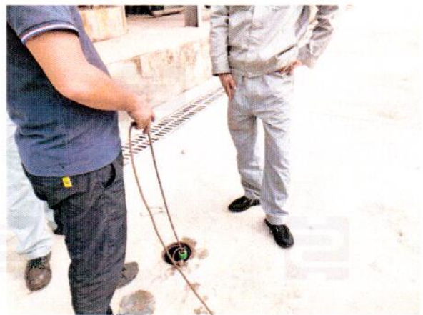
3#地下水监测井（☆3）
