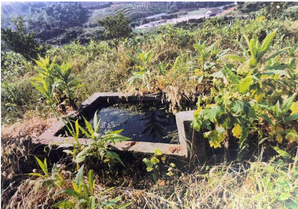
图 8.2-1 田间沼液储存池
