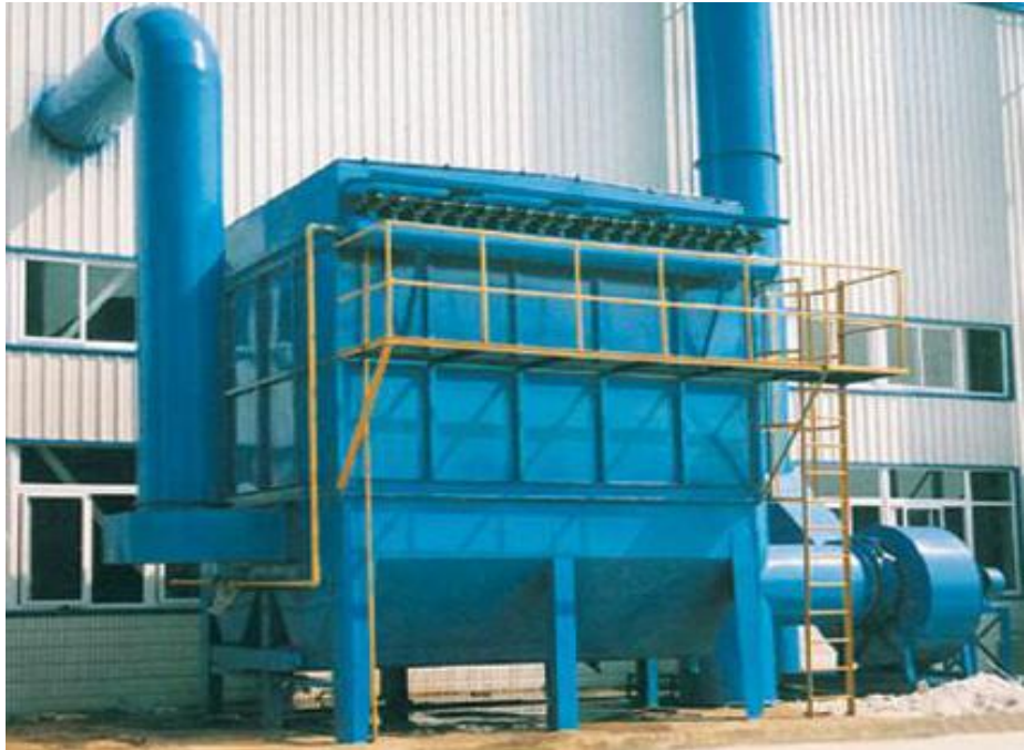
图 9.2-1 除尘设施照片（示例）
