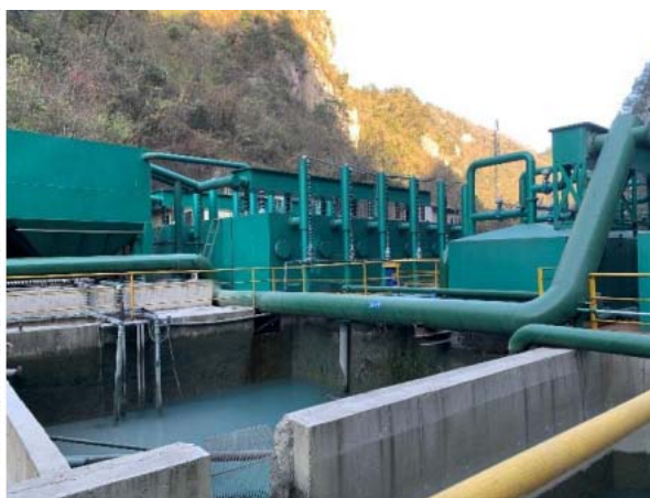
生产废水处理设施
