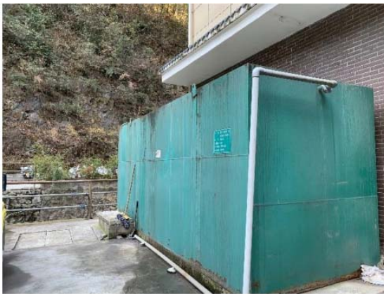
化粪池及一体化污水处理装置
