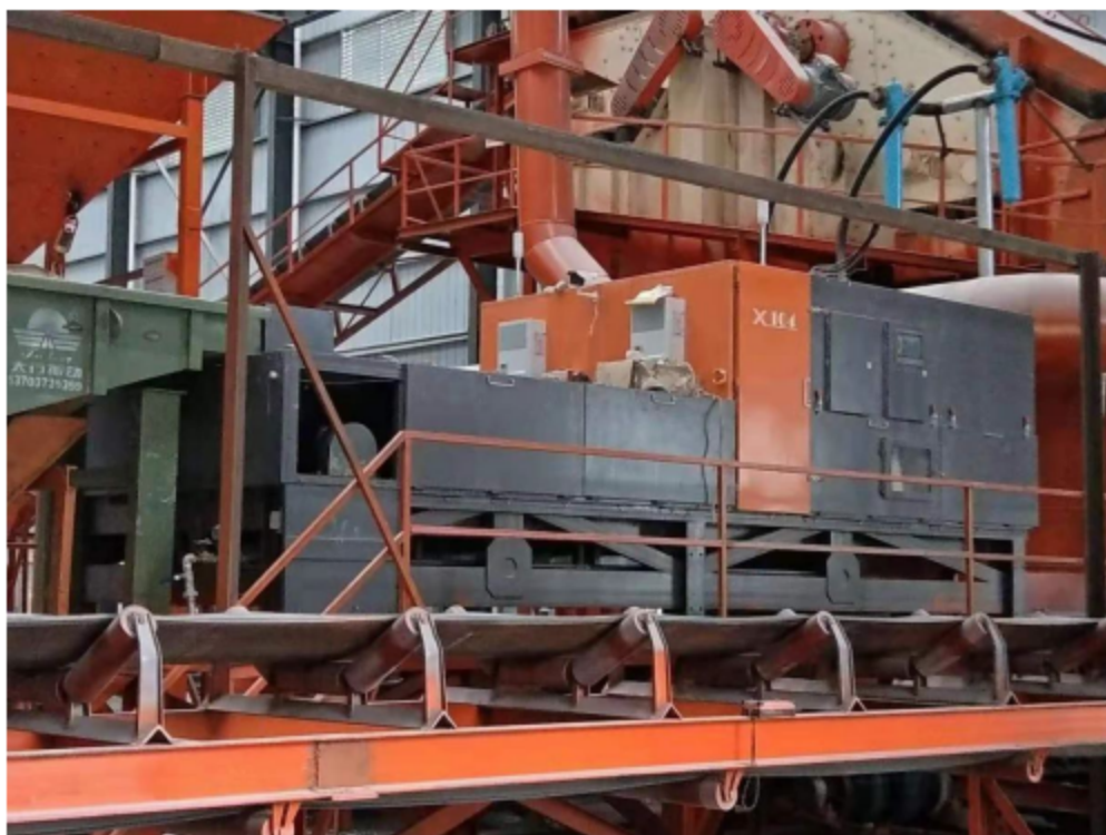
图 5.4-1 光电分选高压气喷系统收尘措施示例图
