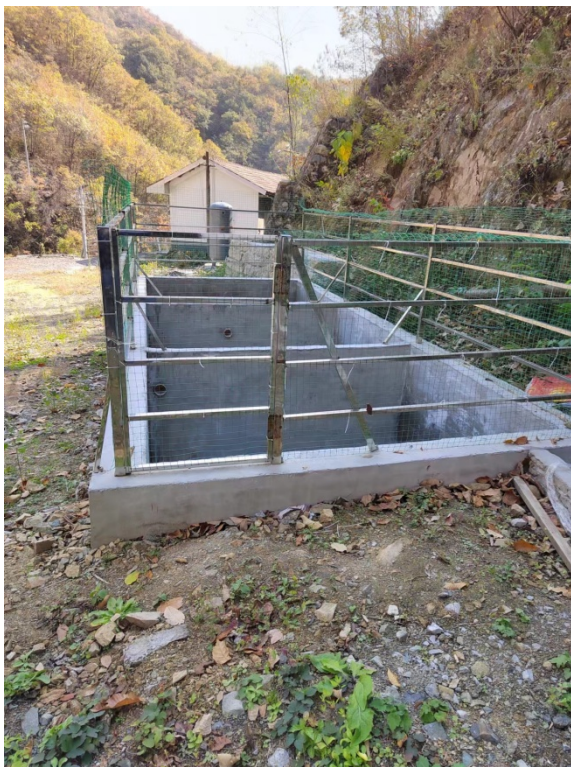
废水处理系统
