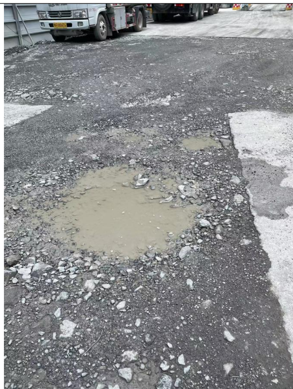
652工业场地地面未完全硬化
