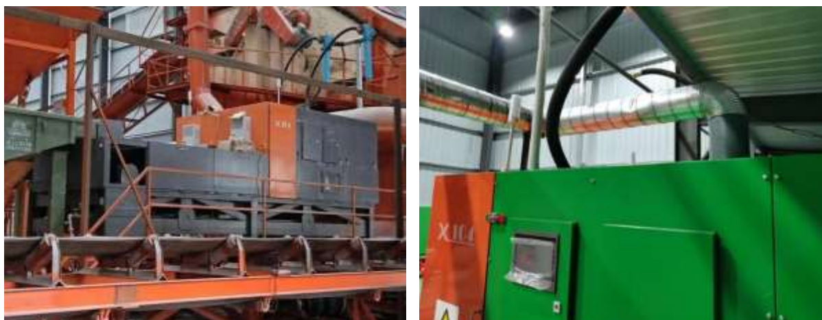
图 4.5-1 光电选矿设备高压气喷系统收尘措施示例图
