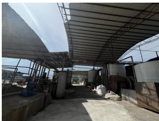
无碱速凝剂生产线
