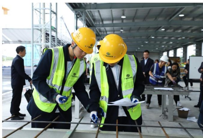
图 建筑工程施工专业学生在广盛培训学校进行钢筋工岗位实训
