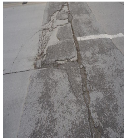
裂缝、板角断裂
